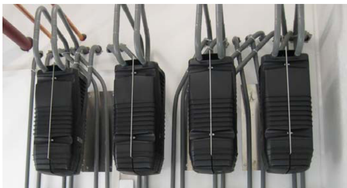
Vulcans instalados espalda contra espalda.
