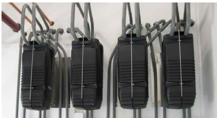
Vulcans instalados espalda contra espalda.
